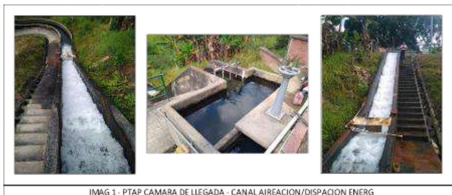
IMAG 1 - PTAP CAMARA DE LLEGADA - CANAL AIREACION/DISPACION ENERG
