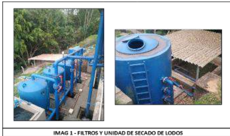
IMAG 1 - FILTROS Y UNIDAD DE SECADO DE LODOS
