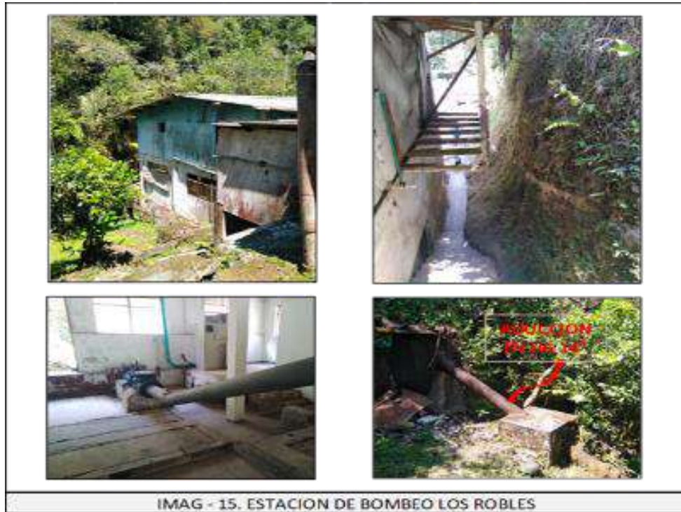
Ilustración 16 Estación del Bombeo Los Robles
