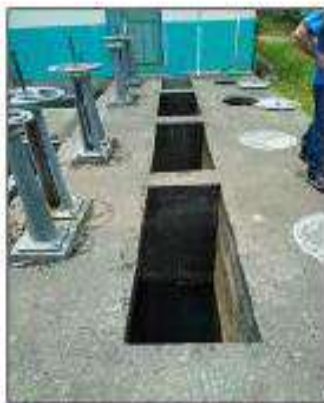
IMAG 4 - UNIDAD DE FILTRACIÓN
