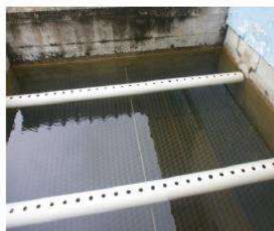
Tanque de sedimentación
