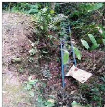
IMAG 2 - ADUCCION DESARENADOR A PTAP
