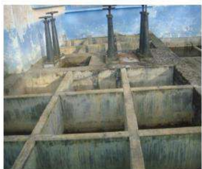
Módulos de floculación
