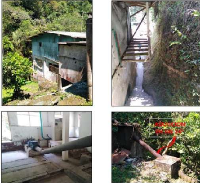
Imagen 12: Estación de Bombeo 1 Roble y La Arenosa. Fuente: Propia
