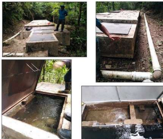
Imagen 7: Bocatoma La Arenosa. Fuente: Propia
