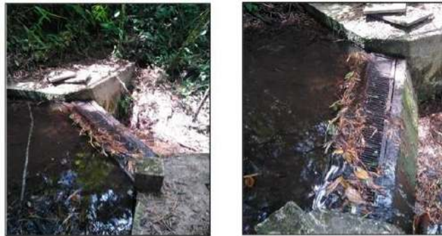
Imagen 5: Bocatoma La Paloma. Fuente: Propia
