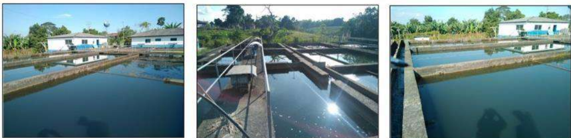
Imagen 9: Estación de bombeo. Fuente: Propia
